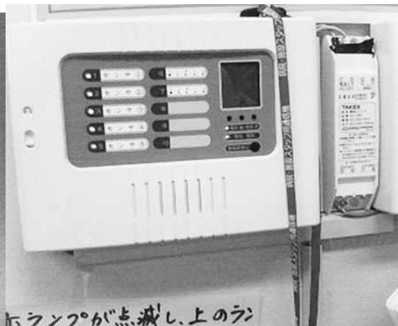
写真15 非常通報システムの受信機
